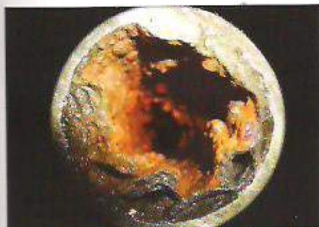
Conditie buizenstelsel 8 jaar na installatie zonder gebruik Aqua-4D.
