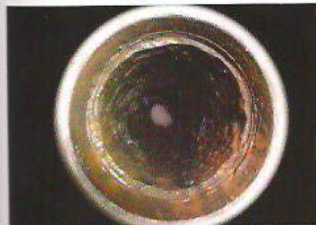
Buizenstelsel zes 6 jaar na installatie met gebruikmaking Aqua-4D.
